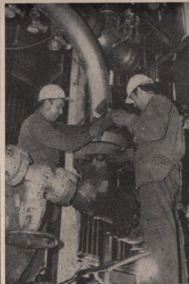
Montaggio di tubature di vapore nel locale turbine eseguito da Giuseppe De Mitri e Riccardo Fogar di Monfalcone.
